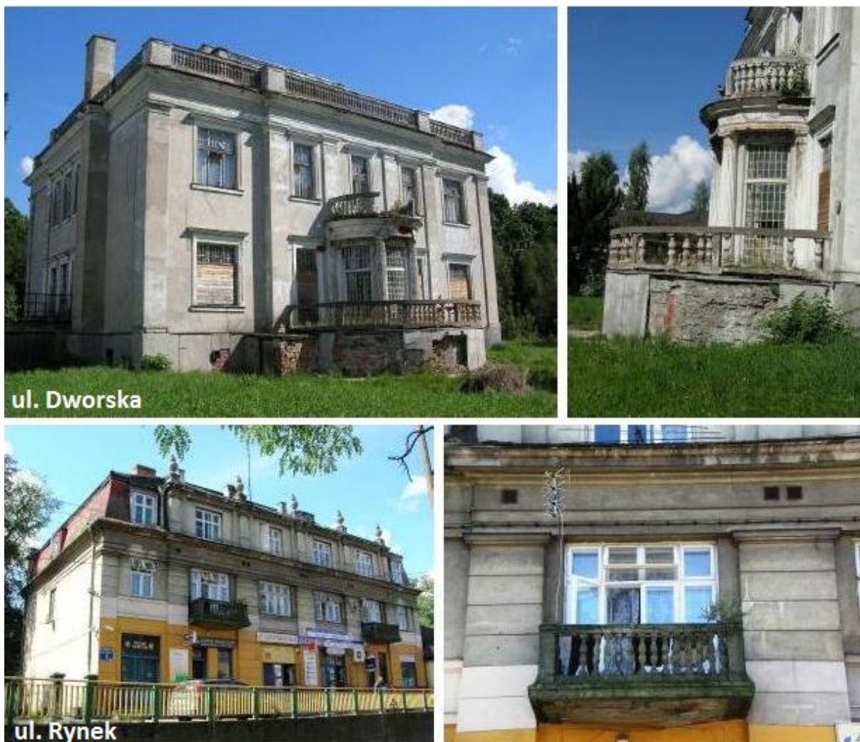
Fotografia 1. Budynki wymagające remontu
