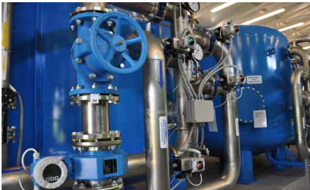
Na zdjęciu: Stacja Uzdatniania Wody w Brwinowie została rozbudowana i unowocześniona w 2013 r., w ramach projektu „Czyste życie – gospodarka wodno-ściekowa w gminie Brwinów”.
